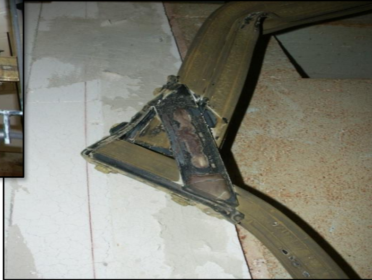
A vízszintes és függőleges szerelősínek deformációja
